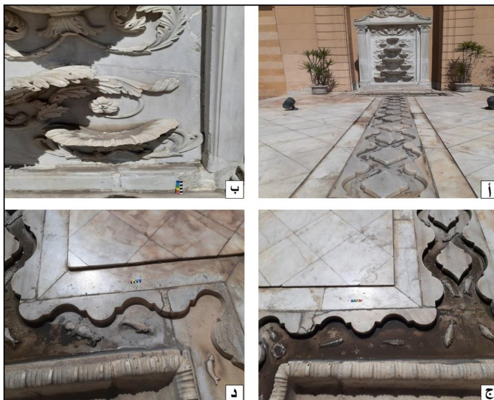
لوحة (1) النافورة الرخامية موضوع الدراسة، ومظاهر التلف المختلفة بها (أ) شكل عام للنافورة الرخامية، (ب) ضعف الوحدات الزخرفية، (ج) التلف الفيزيوكيميائى نتيجة وجود المياه الأرضية والقشرة السوداء، (د) الأسماك البارزة فى الأرضية والكسور الطفيفة الموجودة فى قاعدة الحوض المائى.
