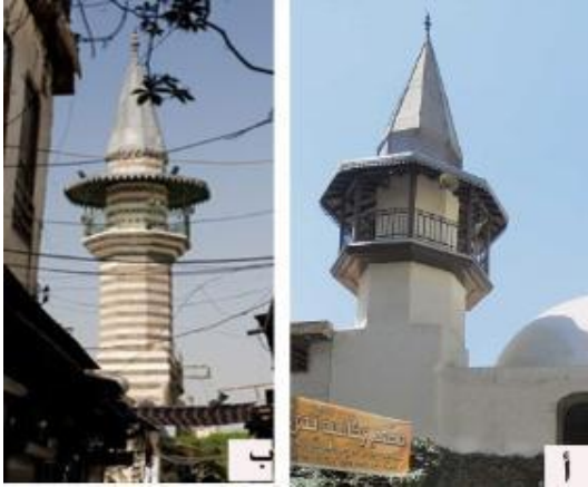
لوحة (١٠): أ- منئذنة جامع البكري بدمشق ١٠٦٩هـ/ ب- منئذنة المدرسة الفتحية بدمشق ١١٥٦هـ/ ١٧٤٢م.
