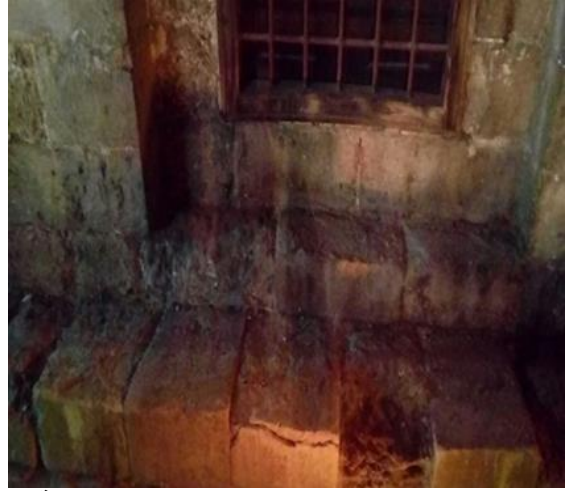
صورة (15) توضح التلف والاتساخات الواضحة وتهدم بعض المناطق اسفل النافذة. تصوير الباحثة.
