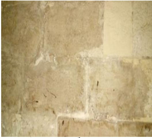
صورة(22) توضح حالة الجدران الشرقي للمدخل.
