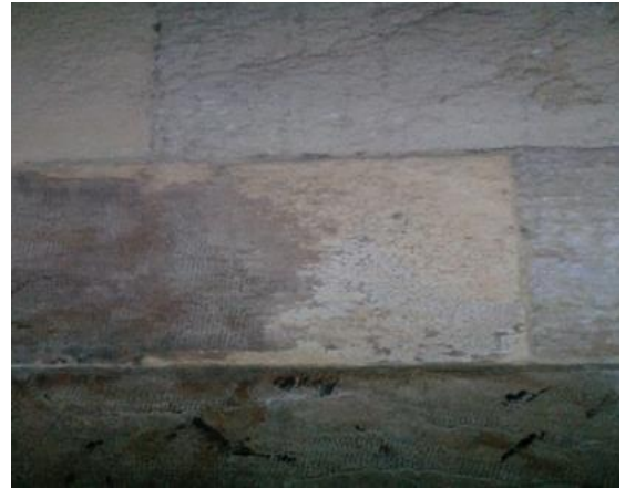
صورة(21) توضح الاتساخات علي الحجر الجيري نتيجة سوء تعامل المجموعات الشبابية في اثناء الحفلات المقامة.
