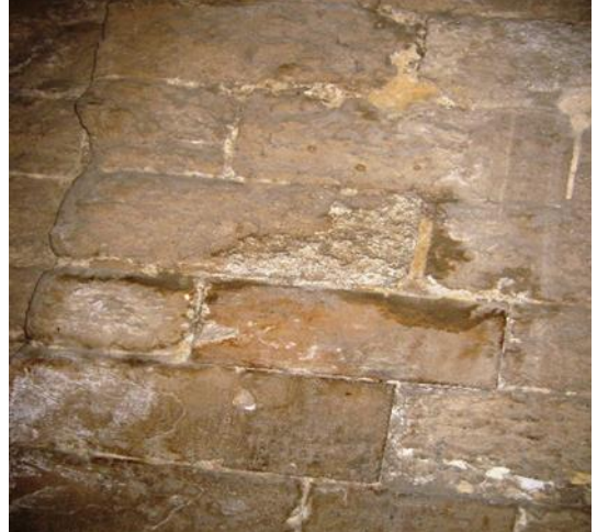
صورة(19)توضح الاملاح والرطوبة علي اجار الجدار.
