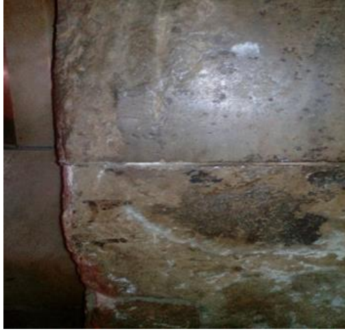
صورة(20) توضح التلف بالجدار الملاصق لباب المدخل.
